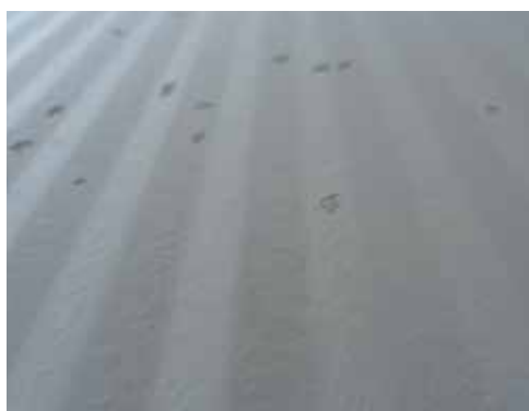
Esempio di blistering
